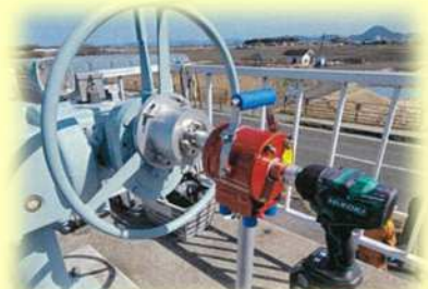
水門巻き上げ機
